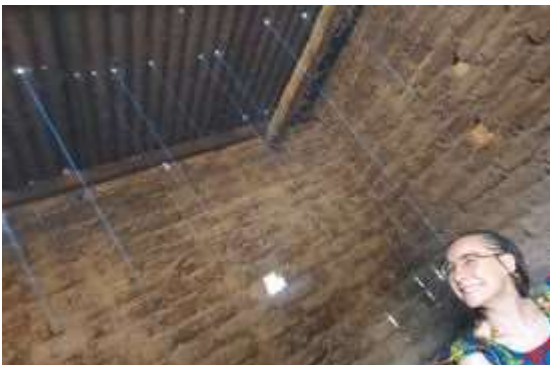
Le toit de la cuisine avec les trous qui laissent passer le soleil... mais aussi la pluie
